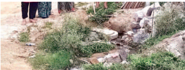
అడర్ డ్రైనేజీ నుండి బయటకు వస్తున్న మురుగునీరు
